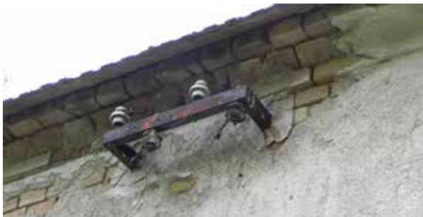
Reste der elektrischen Anlage 2017
